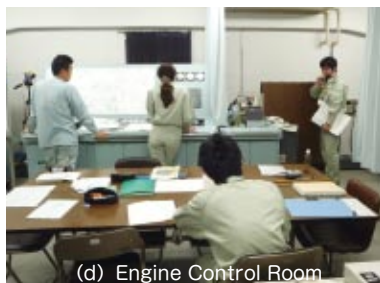
(d) Engine Control Room
